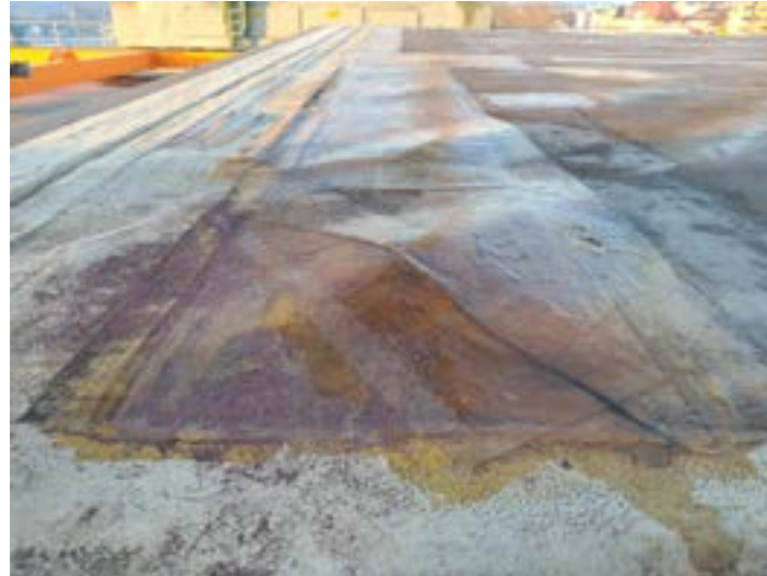
Ausbeulen und Reissen infolge veränderter Ausdehnung am Dach 2 - Schadensklasse 3.
