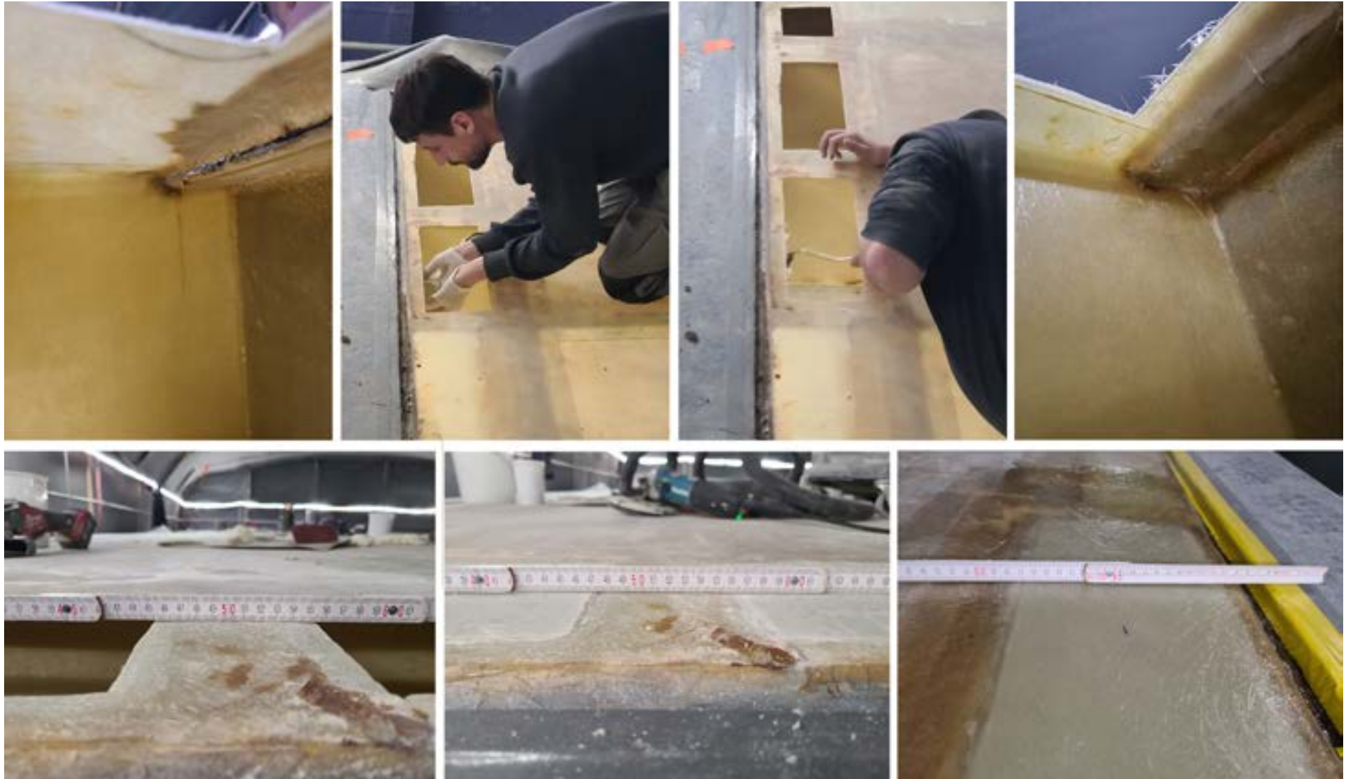
Abriss in Randkassetten Dach Nr. 3. Reparatur nur von der Kassettenin- nenseite möglich.
