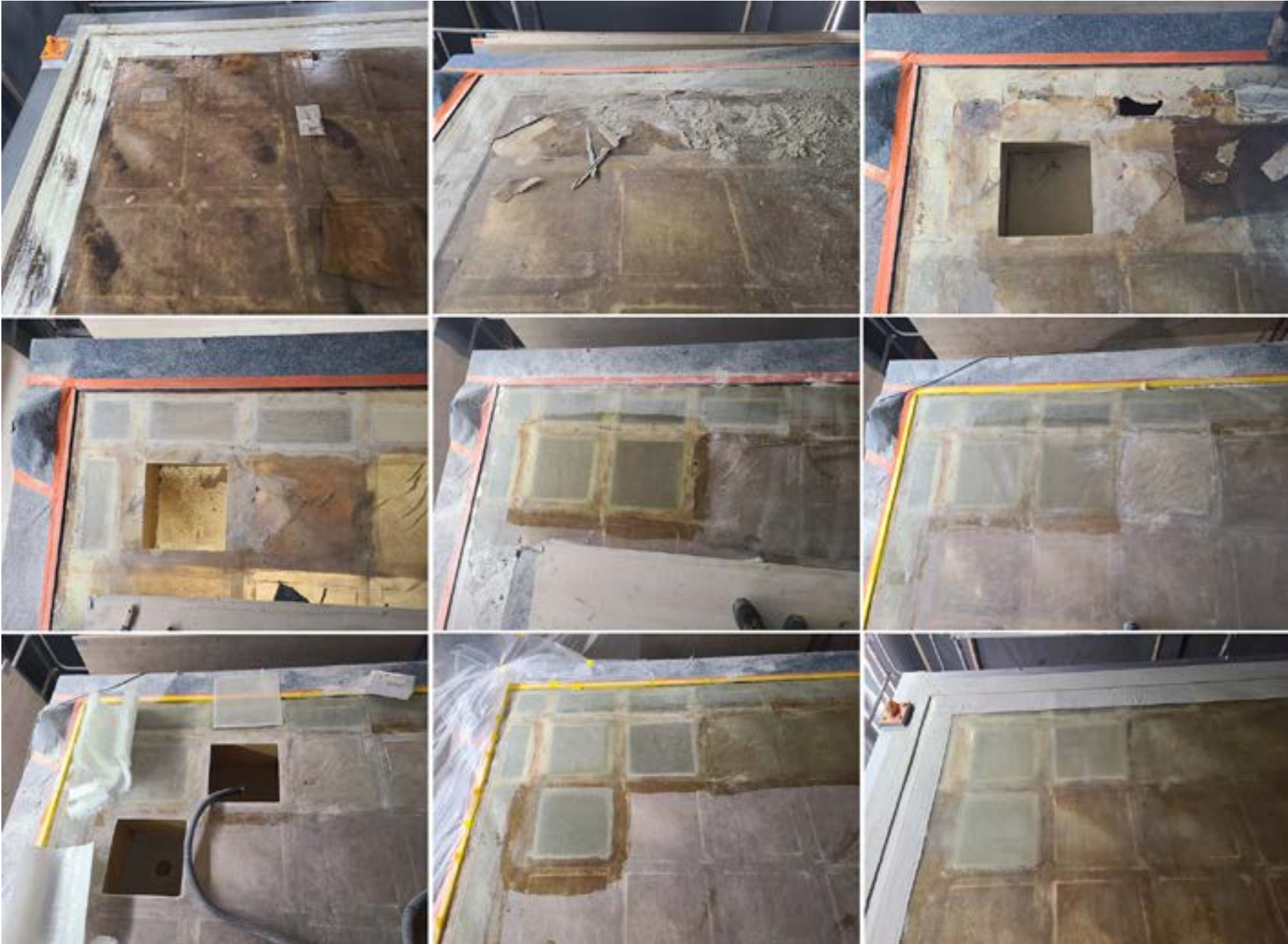
Dach Nr. 2: schrittweises Freilegen und Reparieren der Risse an der Oberseite bzw. runder Probenlöcher an der Unterseite.
